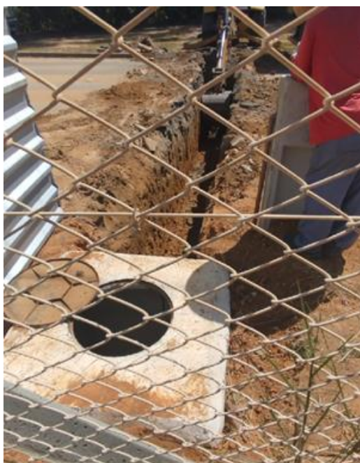
Figura 31 – Ponto de ligação de esgoto aberto pelo SAAE. Fonte: Findex/SESI, 2025.
